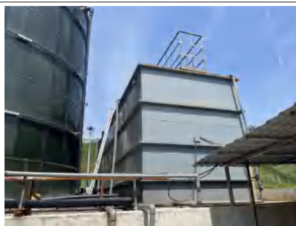
一级反硝化罐+预处理（絮凝沉淀池）、碳源池+围堰（接地罐体）
