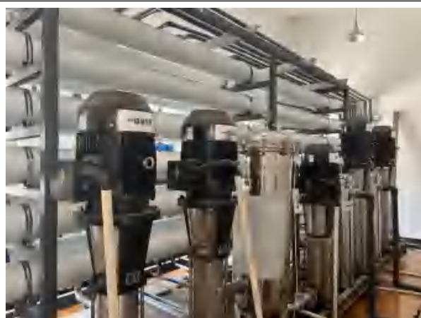
综合设备房一反渗透
