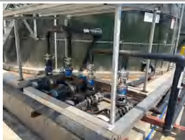
生化区泵（地上）
