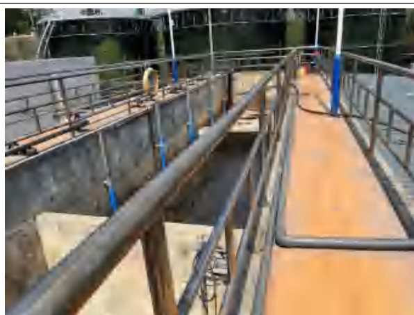
MBR产水池（中间水池）、清水池、好氧池、缺氧池、膜池（接地池体）
