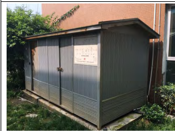
污水处理站设备间
