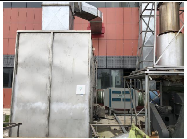
压铸废气处理设施 (喷淋+两级活性炭吸附+2#排气筒 (方管))
