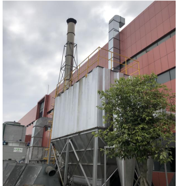
熔化废气处理设施 (布袋除尘+1#排气筒 (左))
